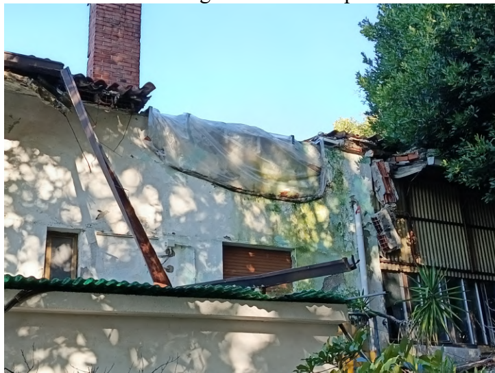
FOTO 62 – stabile civ. 323 di v.le Miramare – Condizioni generali della copertura
