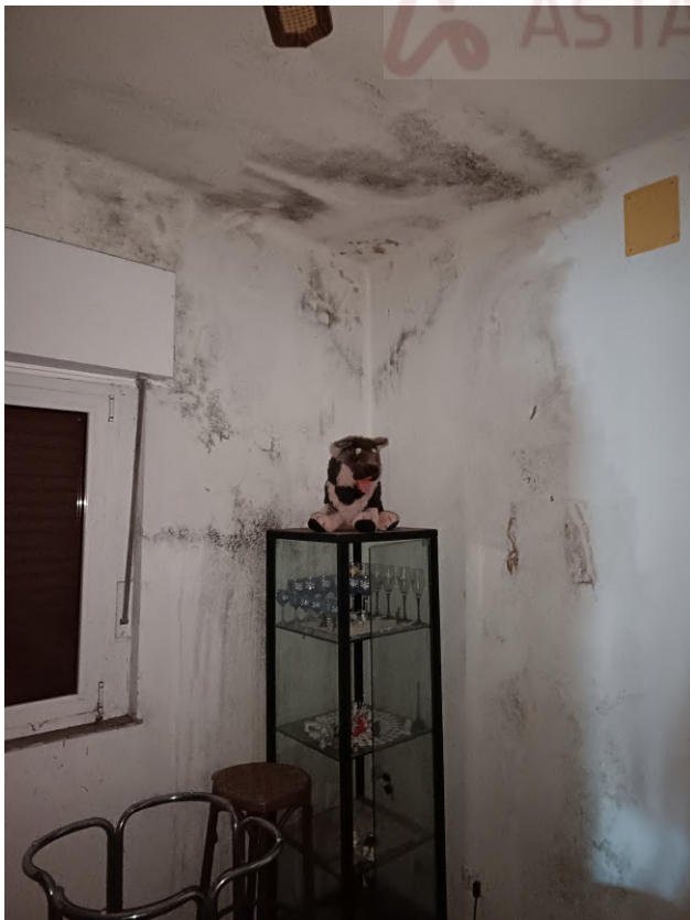
FOTO 58 – stabile civ. 323 di v.le Miramare – Primo piano: entità accessoria “uso ufficio”; fenomeni infiltrativi
