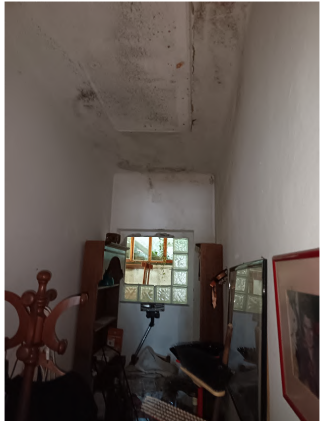
FOTO 59 – stabile civ. 323 di v.le Miramare – Primo piano: entità accessoria “uso ufficio”; fenomeni infiltrativi
