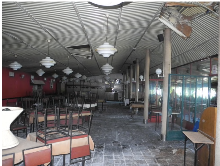
FOTO 25 – stabile civ. 323 di v.le Miramare – zona ristorante; particolare dello stato della copertura
