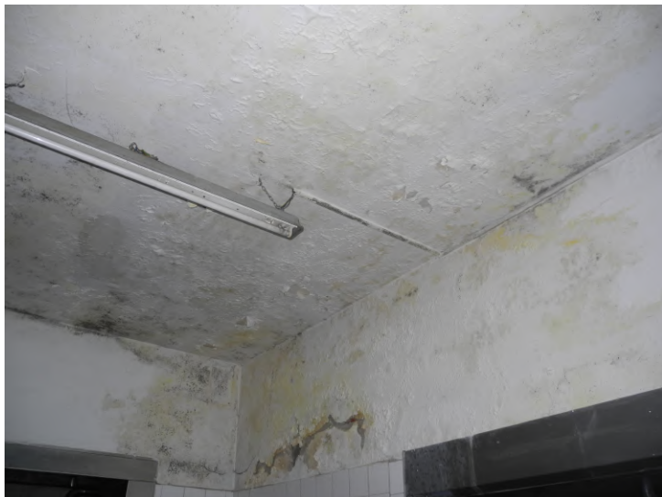
FOTO 14 – stabile civ. 323 di v.le Miramare – zona centrale (ingresso, area bar, cucina), dispense; fenomeni infiltrativi
