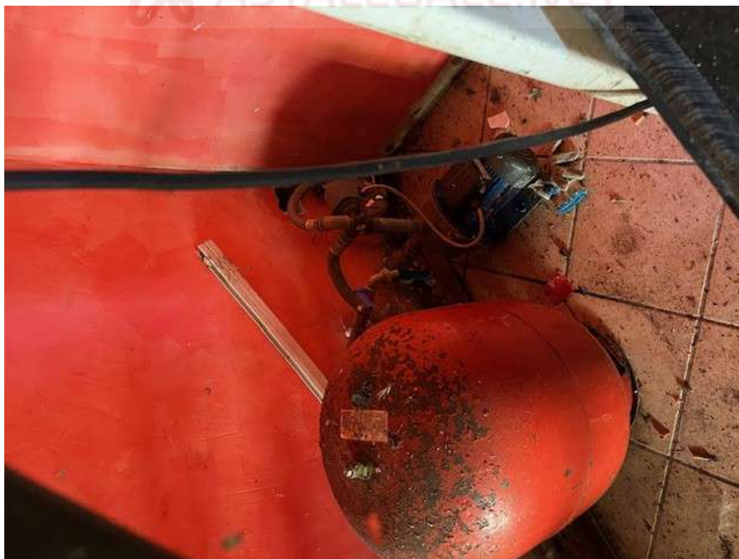
Fotografia 22 – Particolare della pompa dell'acqua del pozzo
