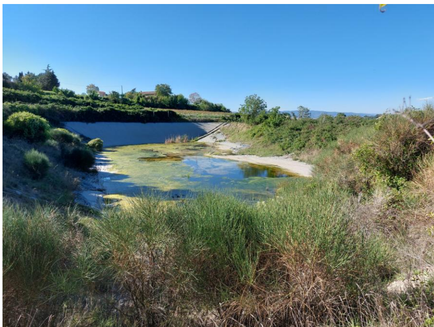
Foto n.87: Particolare della laguna di stoccaggio liquami, ricadente all'interno particelle 111-369-394 del foglio 54 (Bene G). Notare la copertura con membrana in PVC di colore grigio scuro e la recinzione con rete metallica e pali in cemento armato.
