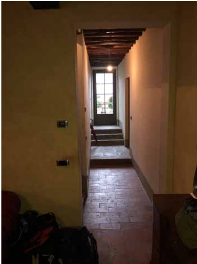
Foto 65 (zona abusiva da ripristinare)
