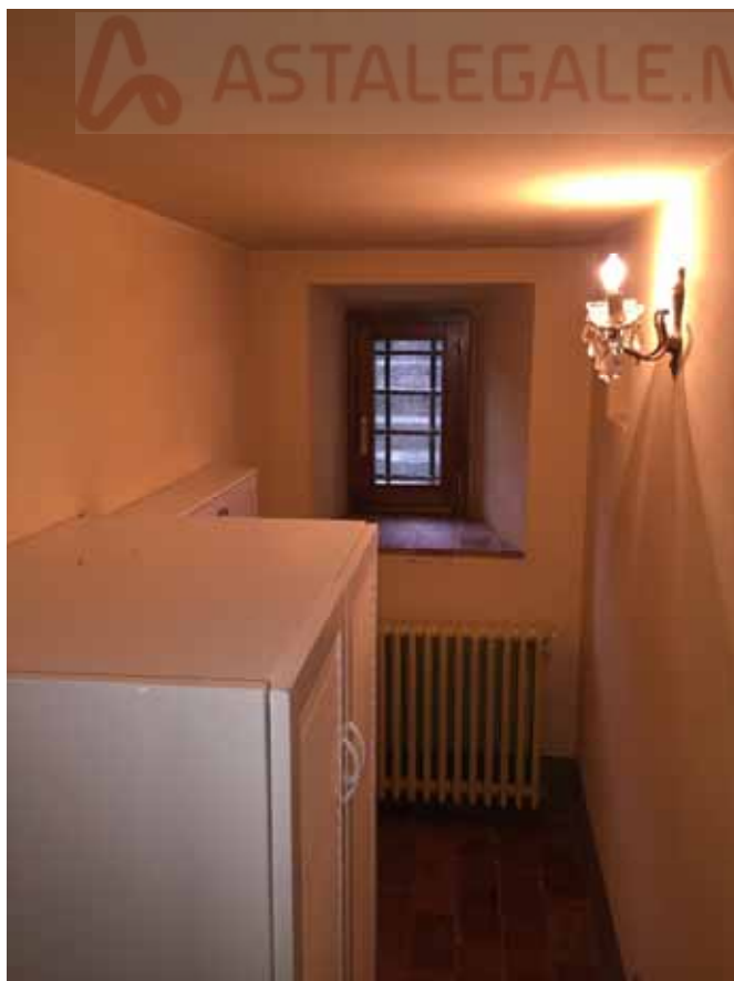
Foto 72 (zona abusiva da ripristinare)
