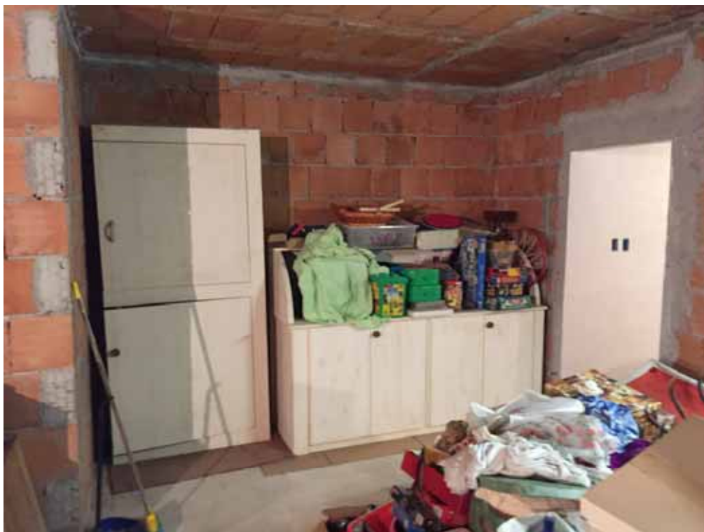
Foto 75 (zona abusiva da ripristinare)
