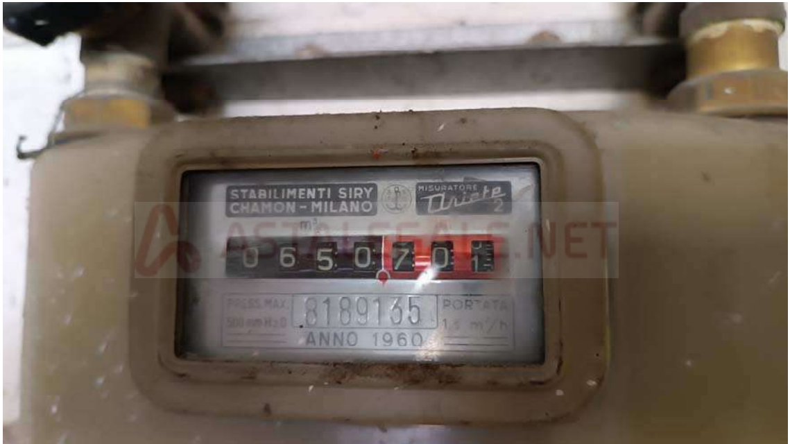
008 - PARTICOLARE CONTATORE GAS
