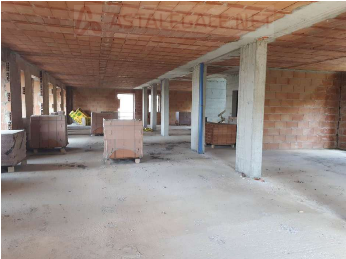
Foto 26 interno allo stato grezzo nei due edifici, porzioni con tamponature e divisori interni realizzati
