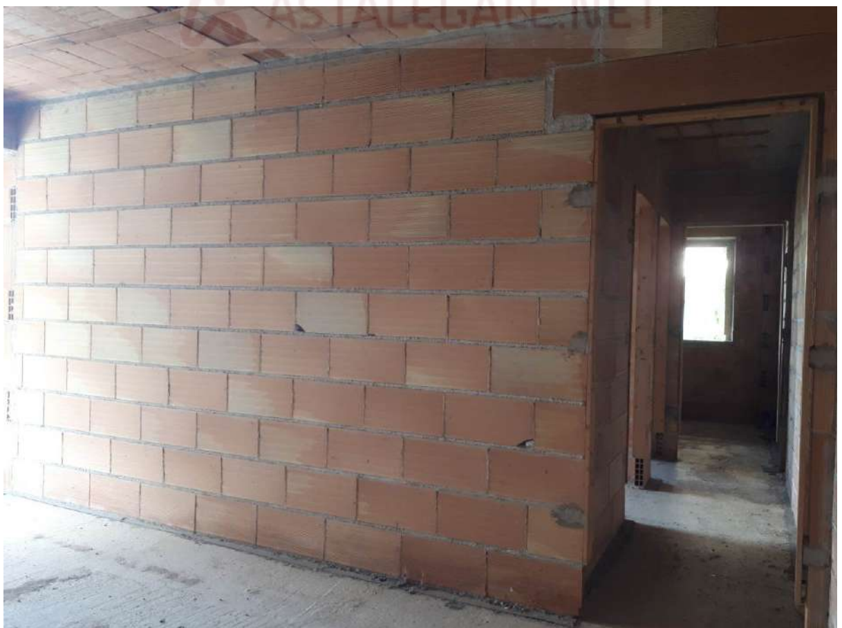
Foto 20 interno allo stato grezzo nei due edifici, porzioni con tamponature e divisori interni realizzati
