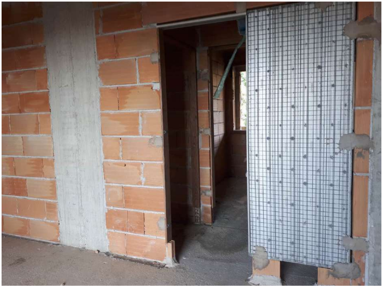
Foto 27 interno allo stato grezzo nei due edifici, porzioni con tamponature e divisori interni realizzati
