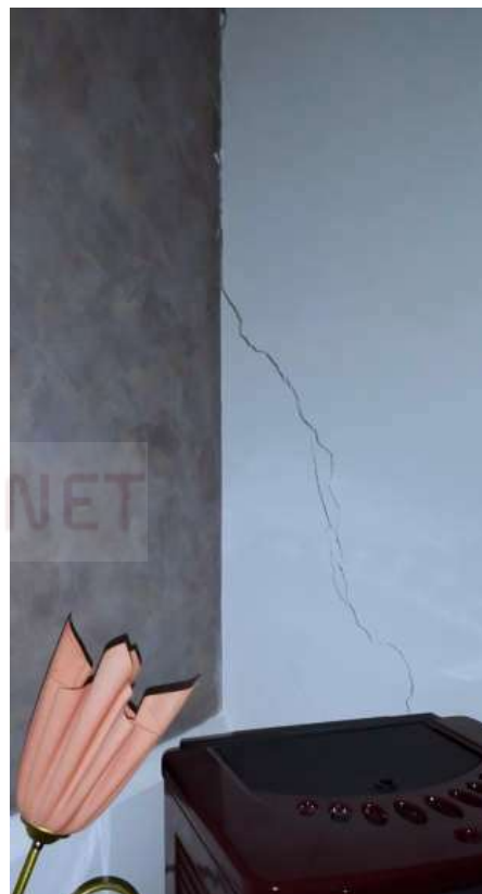
Foto n°11: – Zona giorno al piano terra con fessurazione corrispondente a quella sul prospetto Sud;
