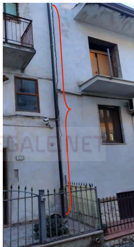
Foto n°4: – Prospetto Nord del fabbricato con indicazione della fessurazione sul prospetto Nord;
