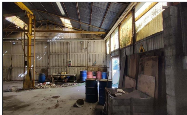
Vista interna immobile E – con rifiuti abbandonati
