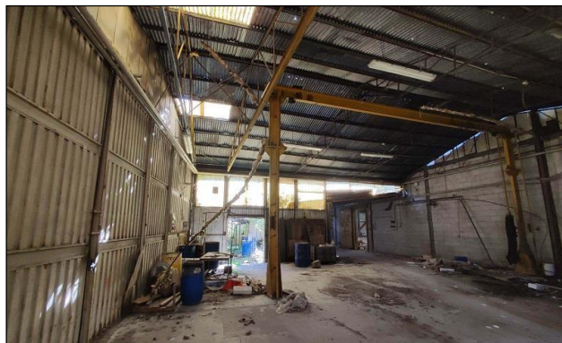
Vista interna immobile E – con rifiuti abbandonati
