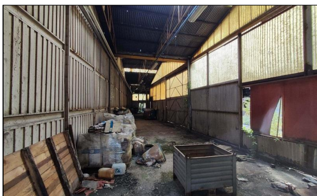
Vista interna immobile E – con rifiuti abbandonati
