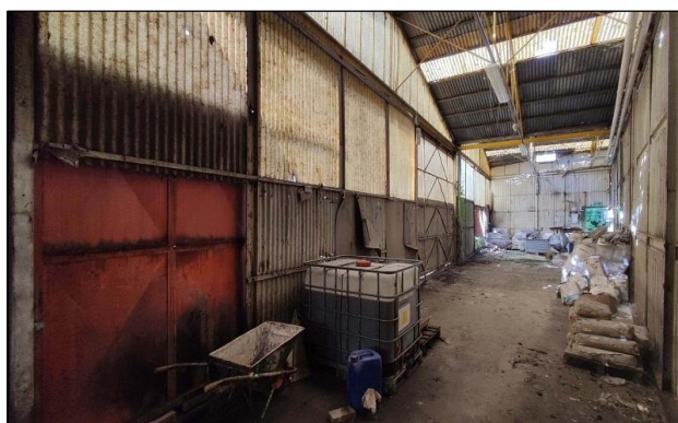
Vista interna immobile E – con rifiuti abbandonati
