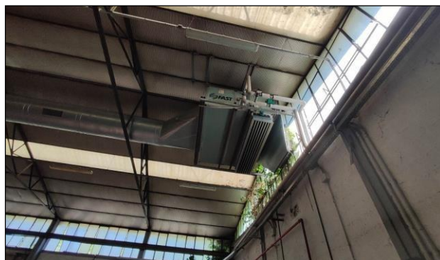
Impianti termici dismessi
