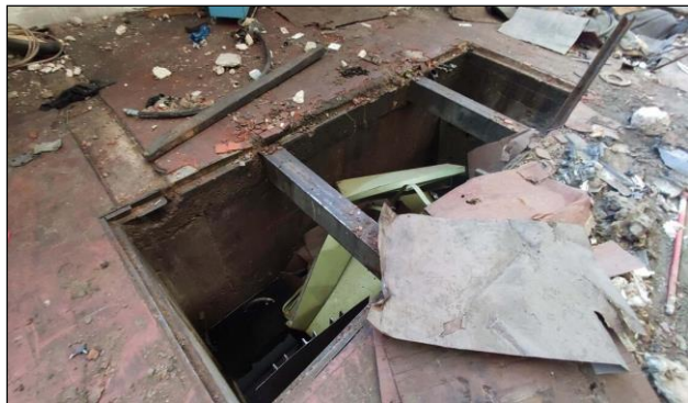
Vasche interrate piena di rifiuti speciali
