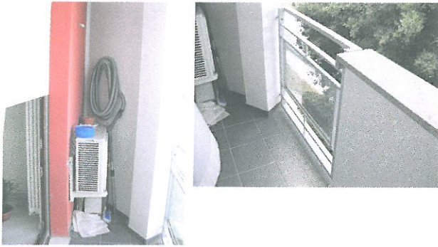
Fig. 22 -23: Balcone B2 (si noti il parapetto parte in cemento armato intonacato e tintecciato di colore chiaro e parte in ferro e vetro, la pavimentazione in gres ceramica da esterno di colore grigio, la presenza del motore dell'impianto di condizionamento)
