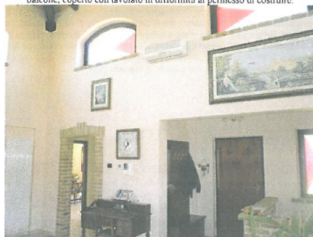
Fig. 26 - Immagine relativa al soggiorno, da cui si scorge la zona di ingresso a destra e la porta di accesso alla zona cucina sulla sinistra; si notino i radiatori in alluminio e lo split dell'impianto di refrigerazione riscaldamento.
