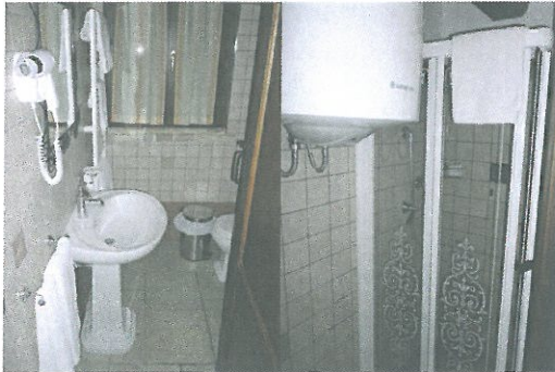
Fig. 58 - Immagine relativa al bagno della camera di cui alla fig. 56; si noti lo scaldabagno elettrico per l'acqua calda sanitaria, i rivestimenti alle pareti con mattonelline delle dimensioni 10x10 di ordinaria fattura, la presenza di un box doccia
