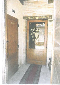
Fig. 28: Immagine relativa all'ingresso al piano terra alla zona destinata alle cucine /sala da pranzo. Si noti la doppia porta di ingresso (quella esterna in legno e quella interna in legno e vetro)
