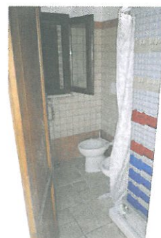
Fig. 64 - Immagine relativa al bagno dell'annesso B di cui alla fig. 63; si noti lo scaldabagno elettrico per l'acqua calda sanitaria, i rivestimenti alle pareti con mattonelline delle dimensioni 10x10 di ordinaria fattura, la presenza di un box doccia)
