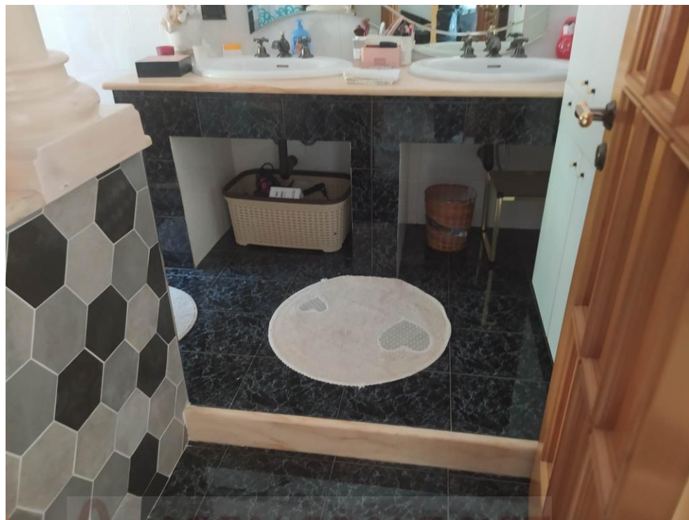
Foto n.16: Vista del bagno di cui alla foto n.14
