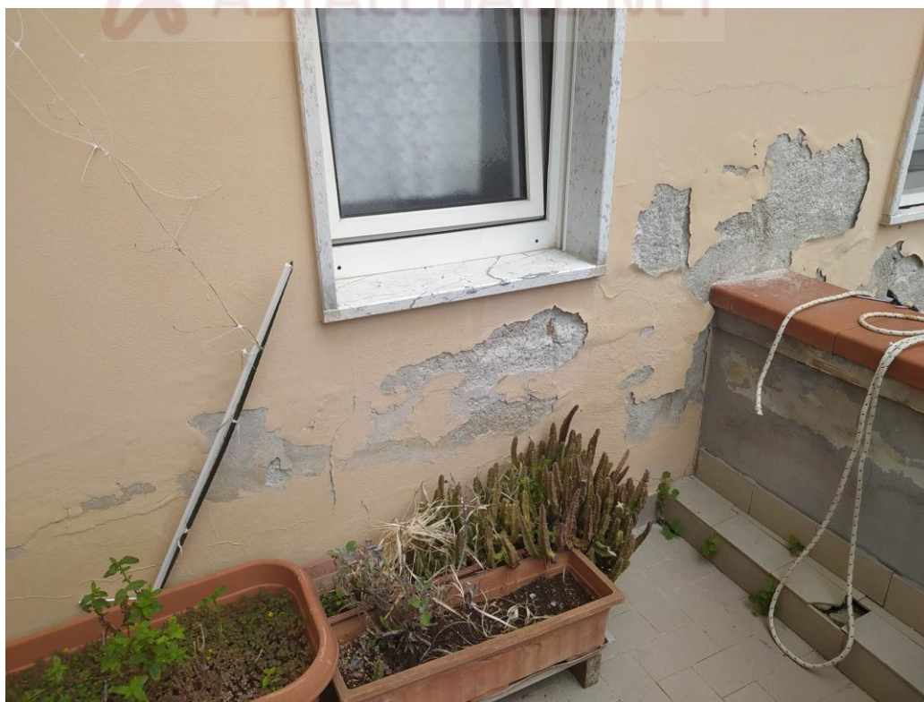
Foto n.19: Vista di alcune zone della facciata che necessita di manutenzione
