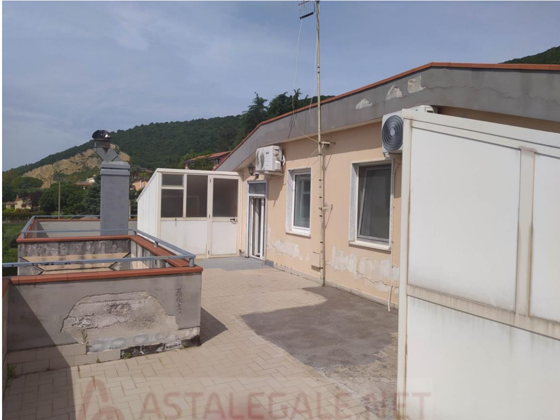
Foto n.20: Vista di alcune zone della facciata che necessita di manutenzione
