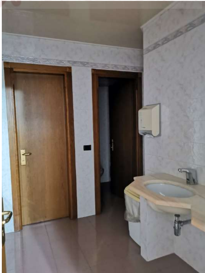
Foto 023 – Bagni di Servizio
