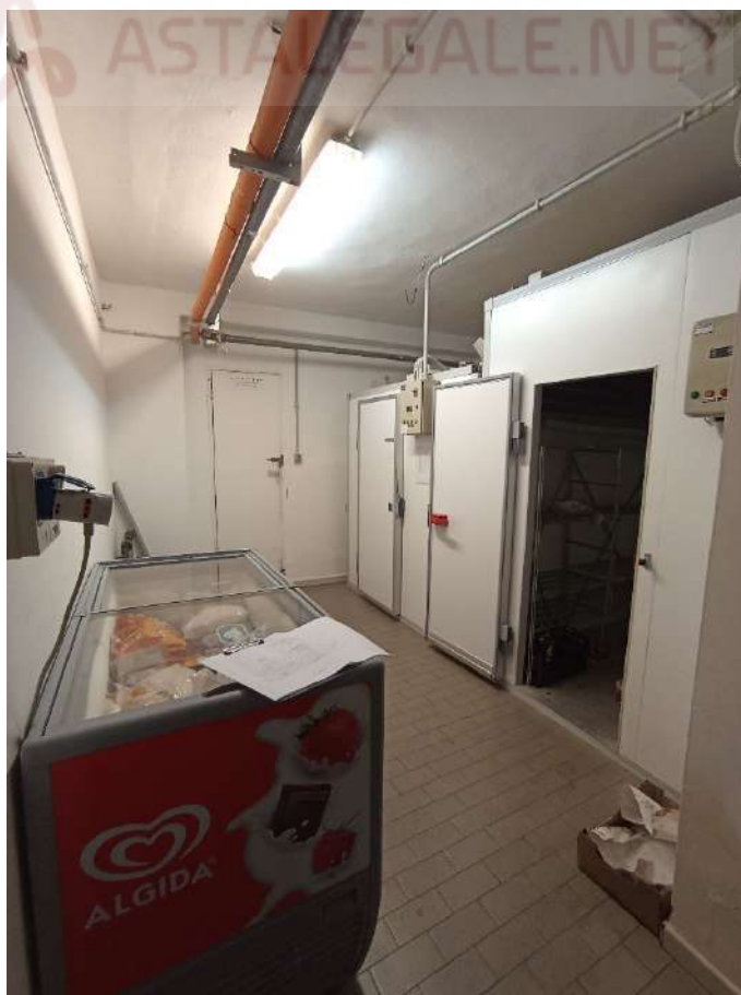
Foto 104 – Zona Celle Frigo
