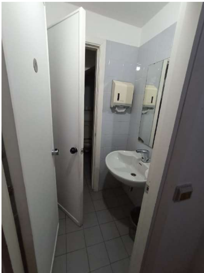
Foto 109 – Bagni di Servizio
