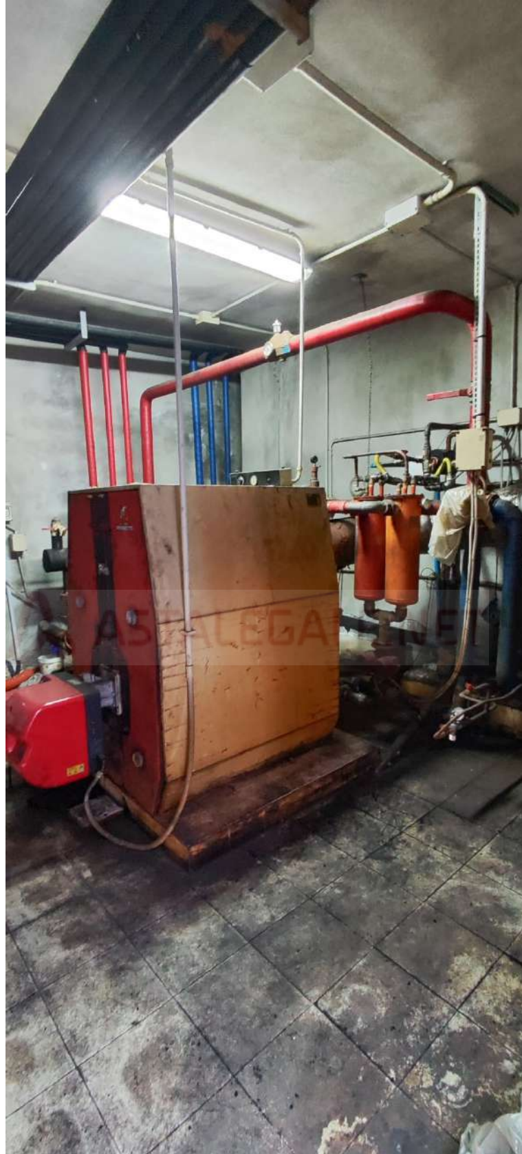
Foto 112 – Dettaglio Centrale Termica
