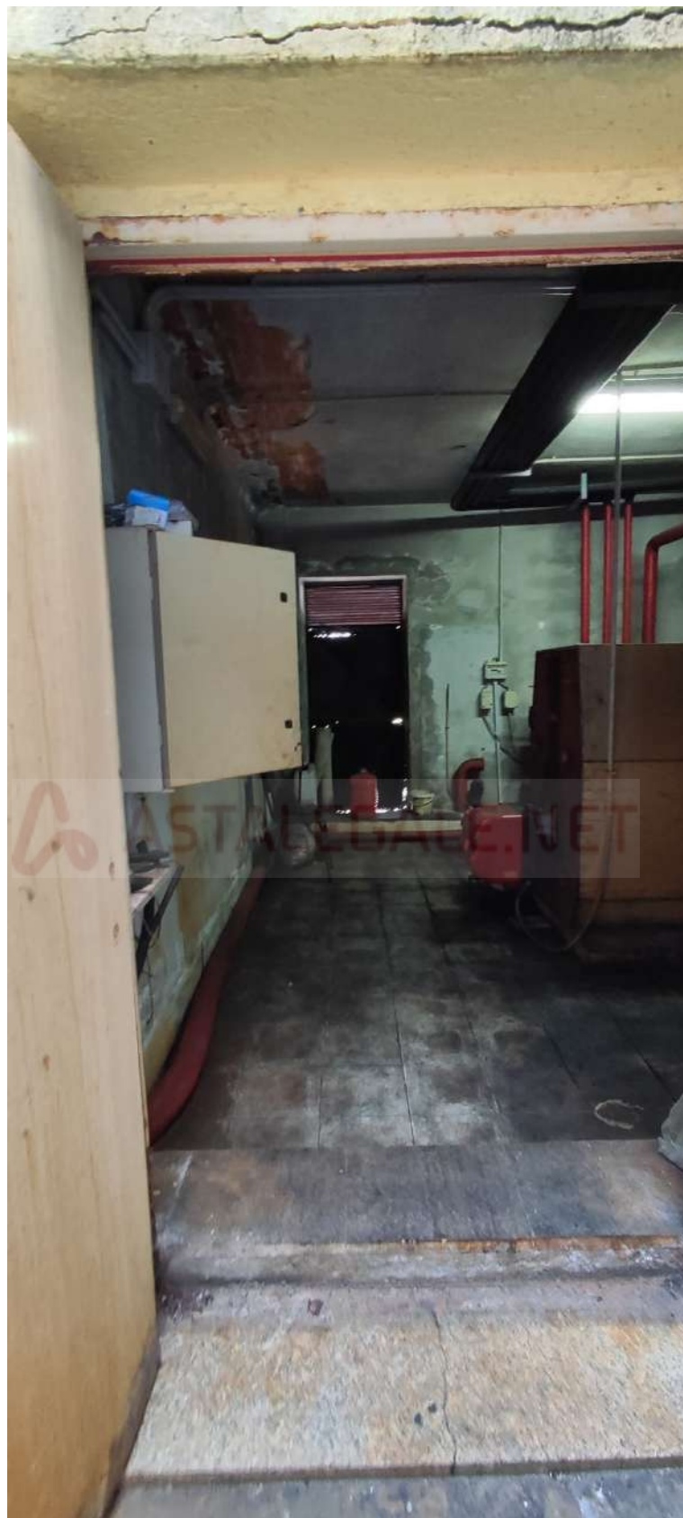
Foto 111 – Ingresso Centrale Termica
