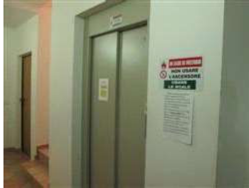
Ascensore interno condominiale - Fabbricato Cagli
