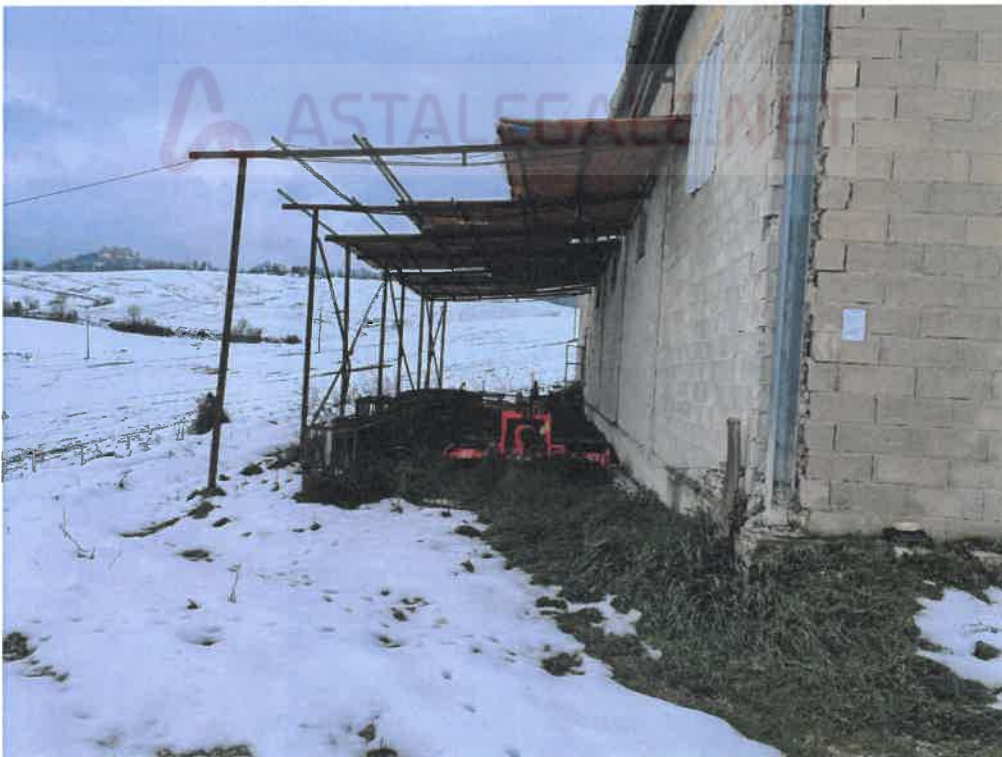
Foto 06 – tettoia abusiva da demolire
