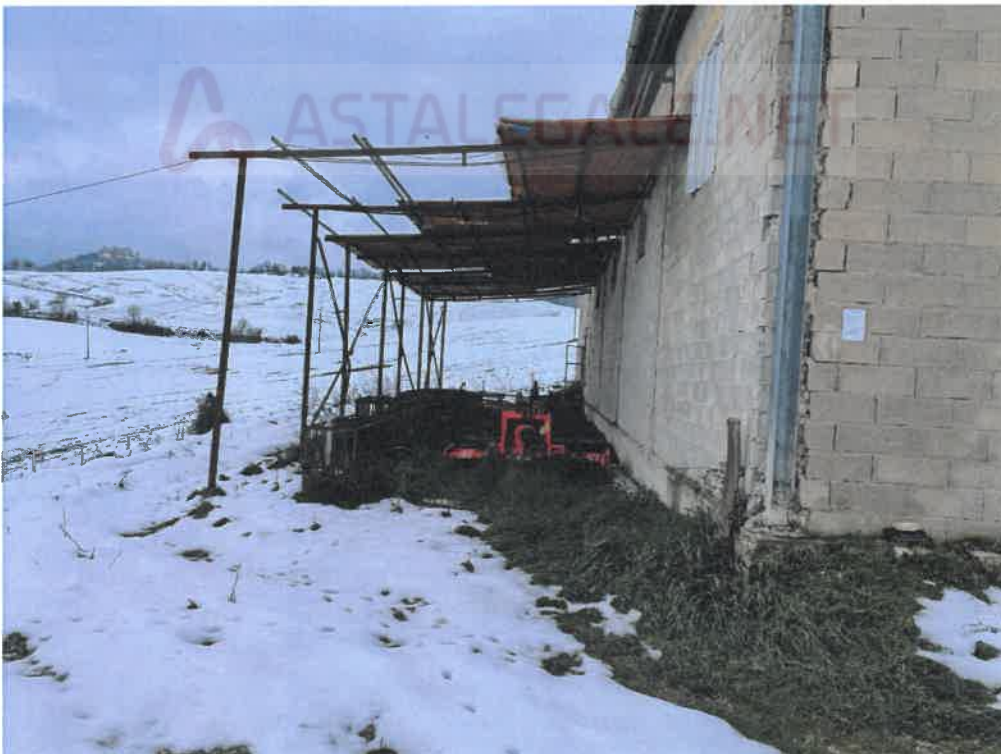
Foto 06 – tettoia abusiva da demolire
