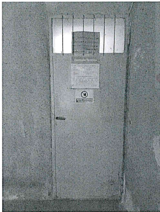
PORTA D'ACCESSO ALLA CENTRALE TERMICA – P.S1
