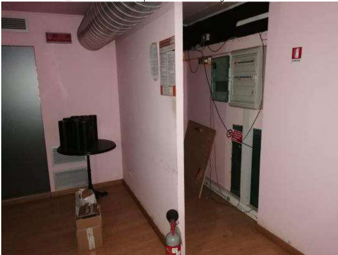
FOTO 28 – quadro elettrico ex sala giochi
