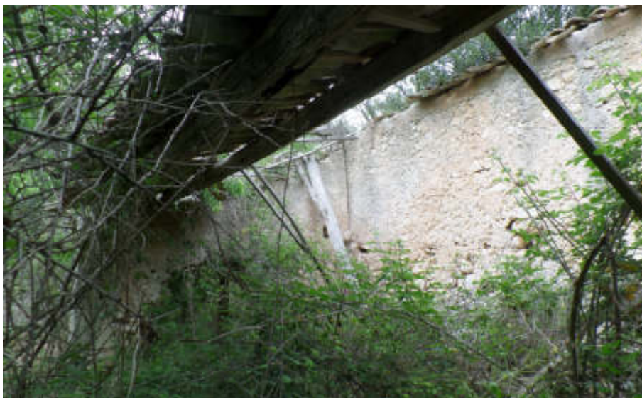
Foto n° 5.7. C.da Piana. Fg. 30, P.lla 105: Fabbricato diruto
