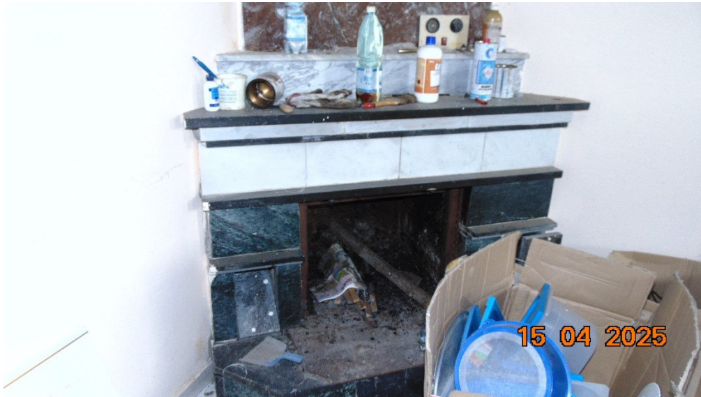
Particolare camino (soggiorno/pranzo)
