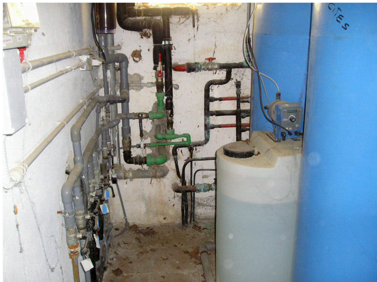
FOTOGRAFIA 46 - Piano Seminterrato / Vani Tecnologici
