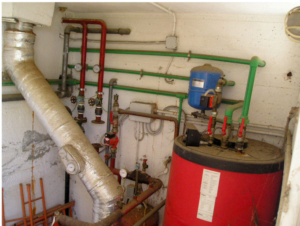
FOTOGRAFIA 48 - Piano Seminterrato / Centrale Termica
