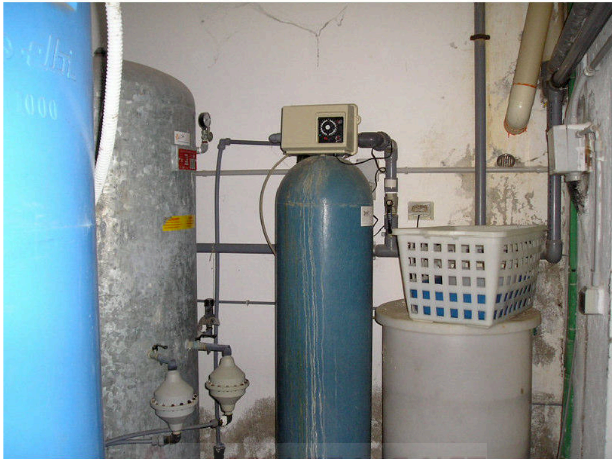
FOTOGRAFIA 45 - Piano Seminterrato / Vani Tecnologici
