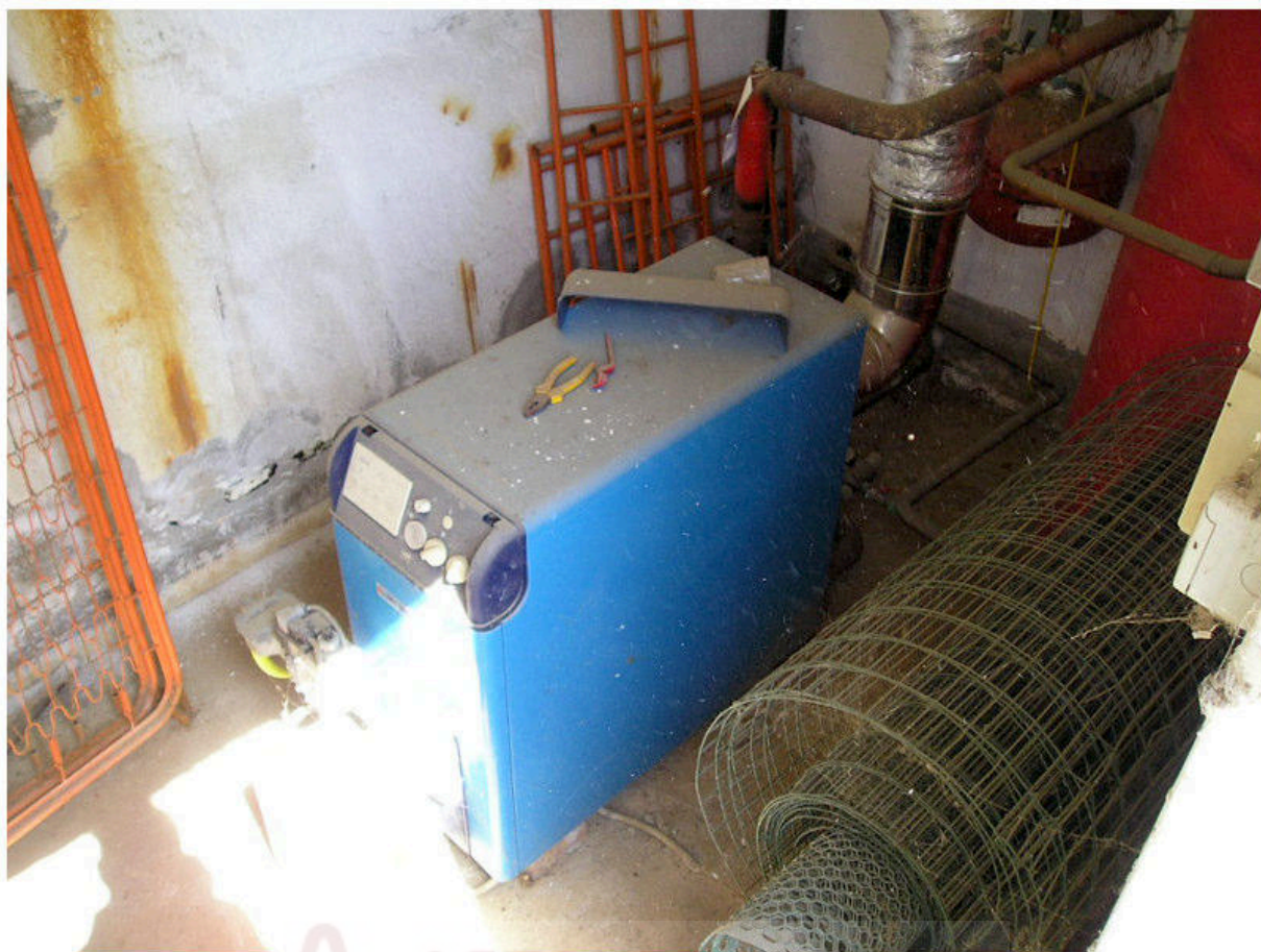
FOTOGRAFIA 47 - Piano Seminterrato / Centrale Termica
