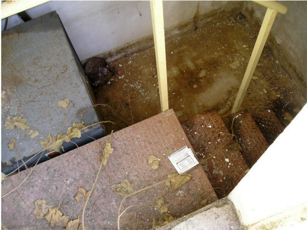
FOTOGRAFIA 49 - Piano Seminterrato / Vano Tecnico Ascensore
