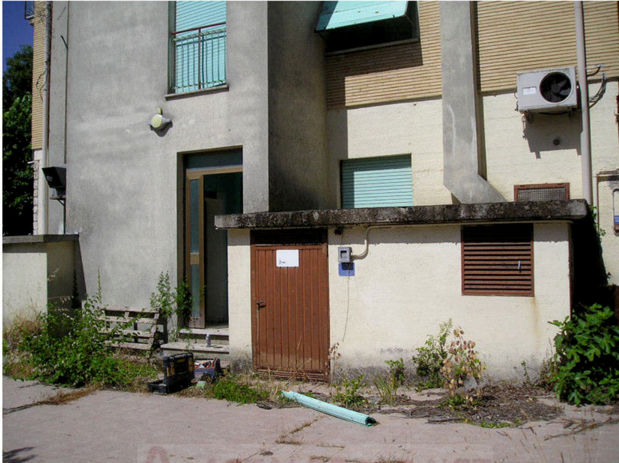
FOTOGRAFIA 15 - Esterno / Centrale Termica
