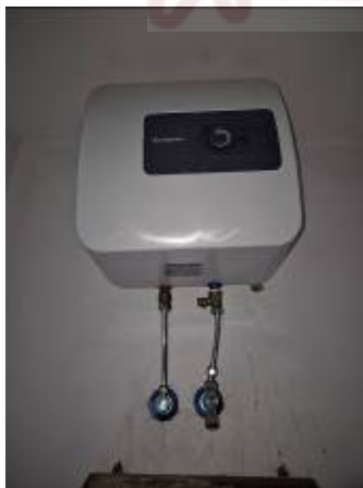
Scaldabagno – Bagno piano terra
