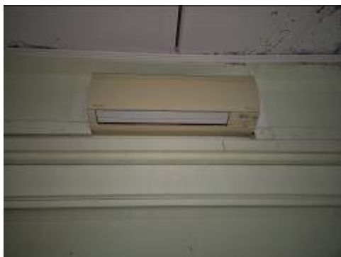
Condizionatore – Ufficio lato nord-est
