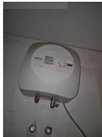
Scaldabagno – Bagno piano primo
