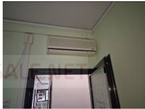
Condizionatore – Ufficio centrale lato sud-ovest
