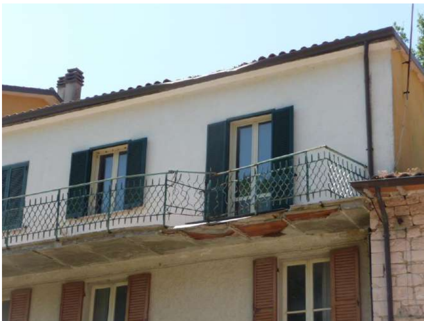
Foto n. 4 Particolare tetto e balcone danneggiati
