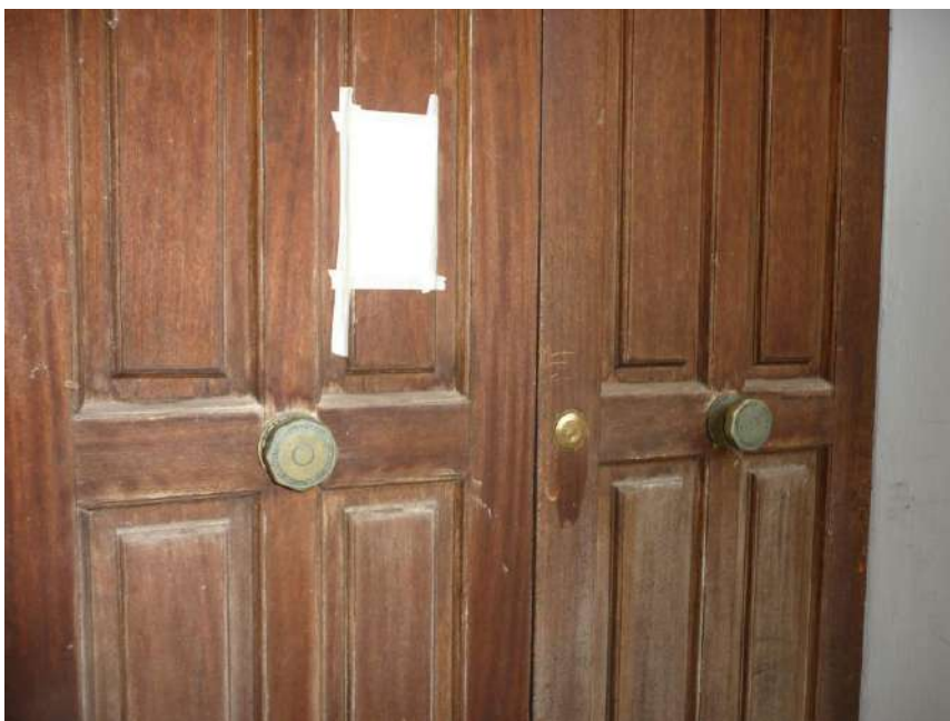
Foto n. 19 Portone dopo accesso forzoso
