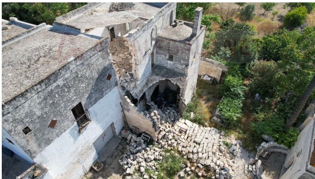
Foto 3 – Fabbricato crollato (vista frontale)
