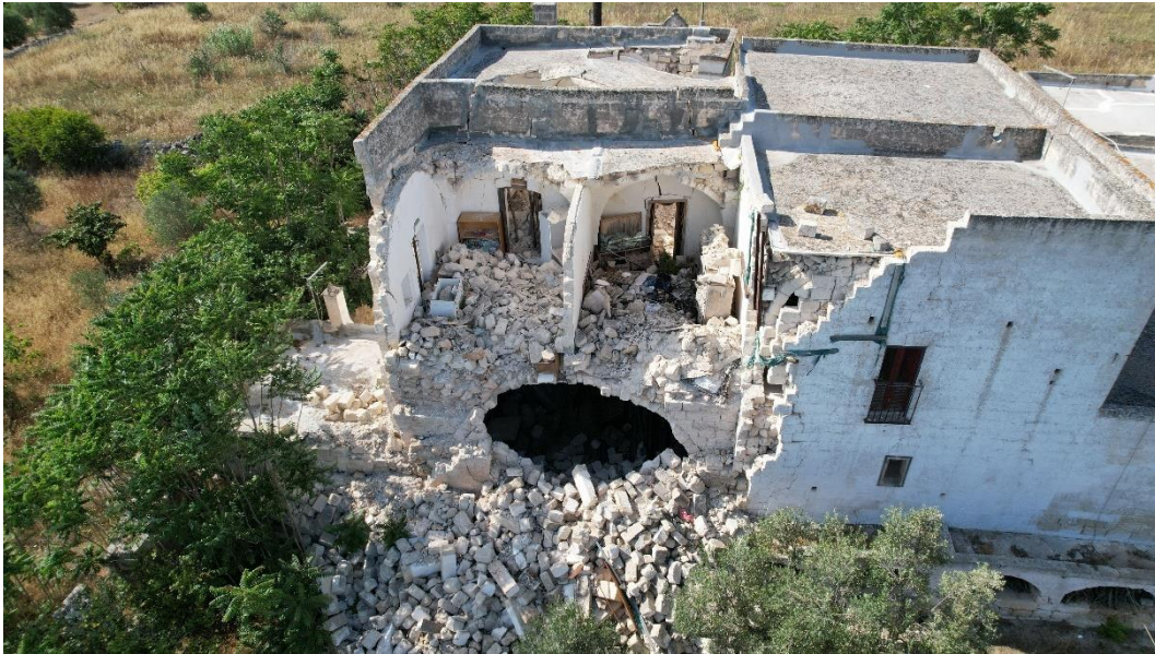
Foto 4 – Fabbricato crollato (vista sul retro)
