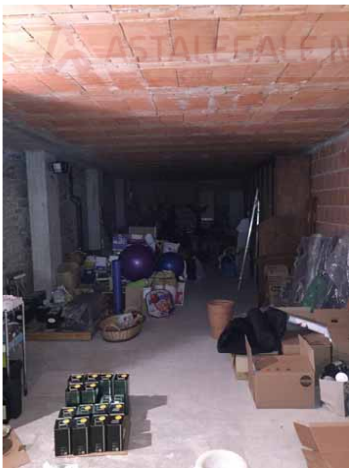
Foto 76 (zona abusiva da ripristinare)
