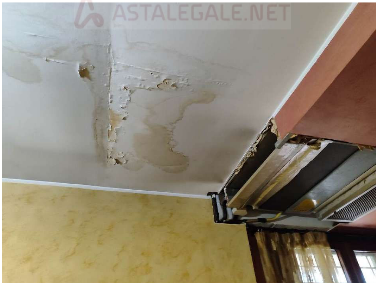
Foto 22 - Interni piano terra, infiltrazione in cucina
