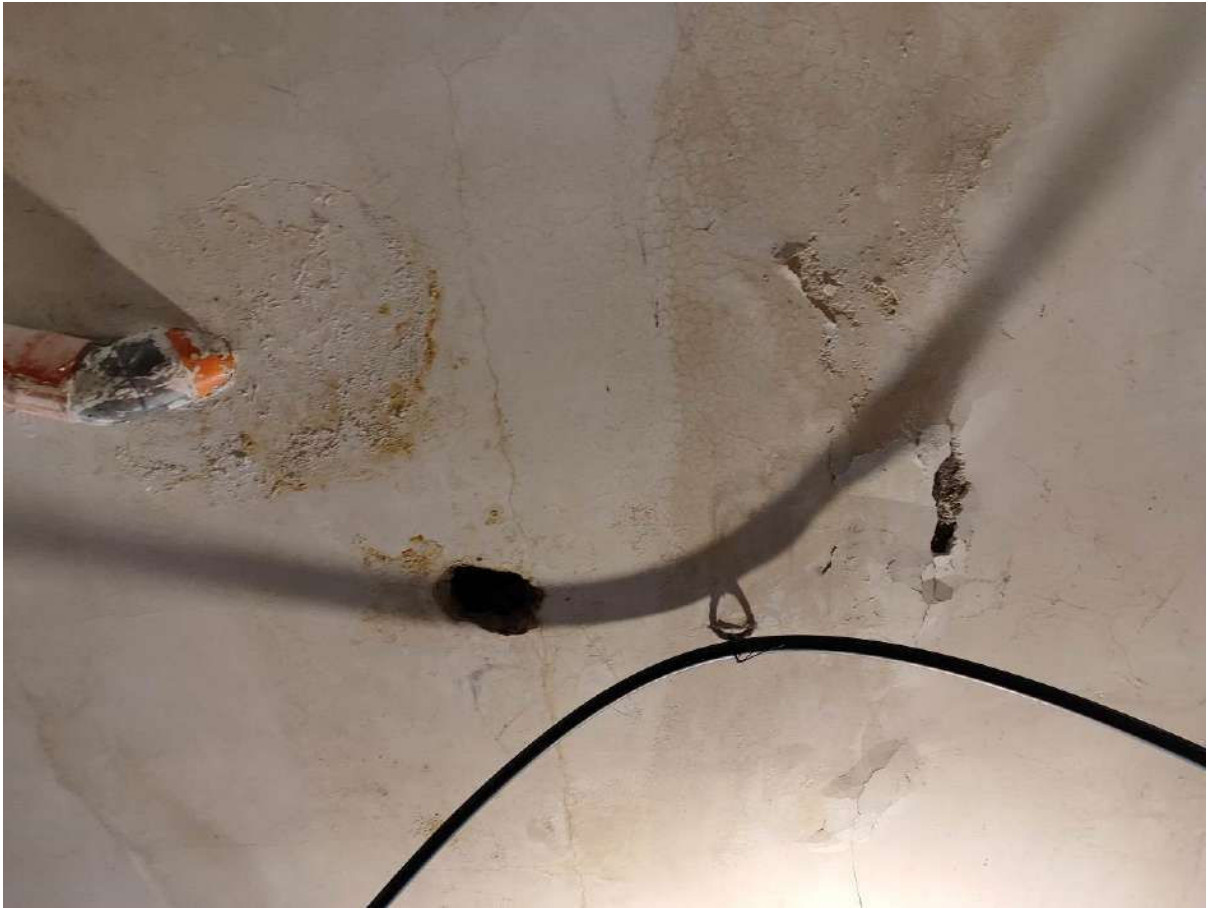
Foto 33 - Interni piano terra, infiltrazione garage
