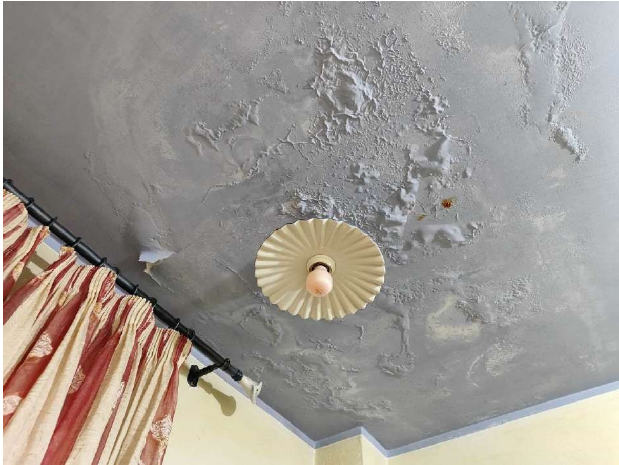
Foto 31 - Interni piano terra, infiltrazione wc
