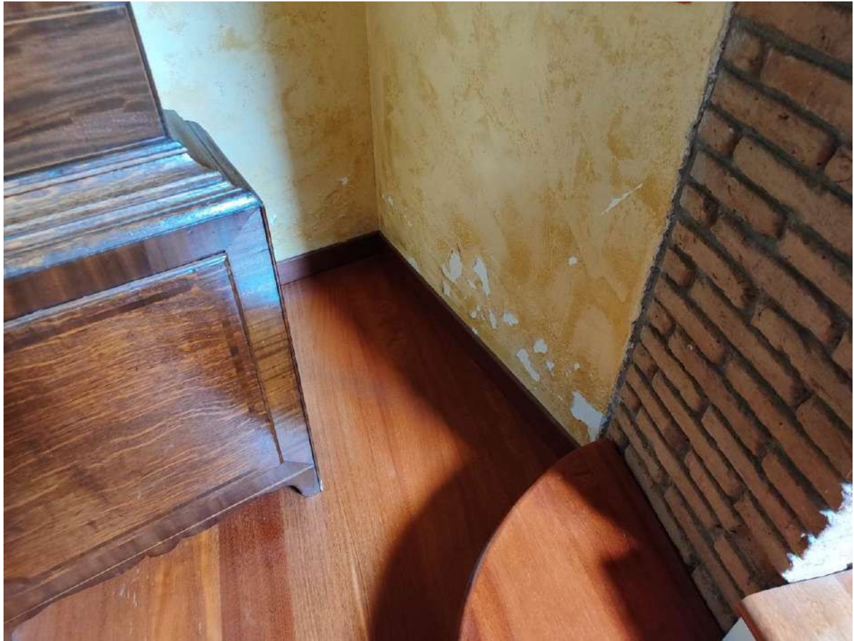
Foto 27 - Interni piano terra, umidità di risalita
