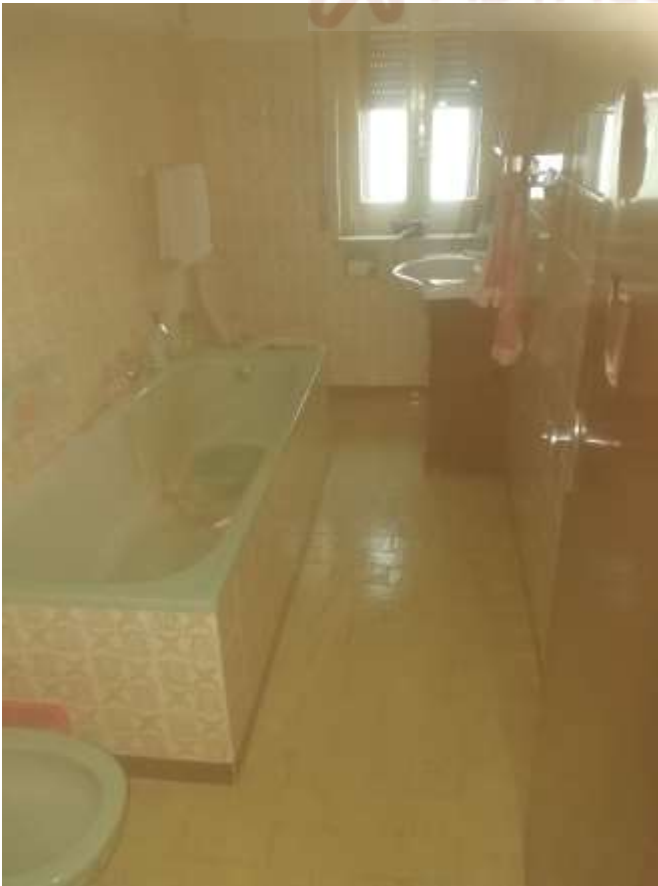
9. Foto interno bagno, al piano secondo (la porta presenta buchi)
