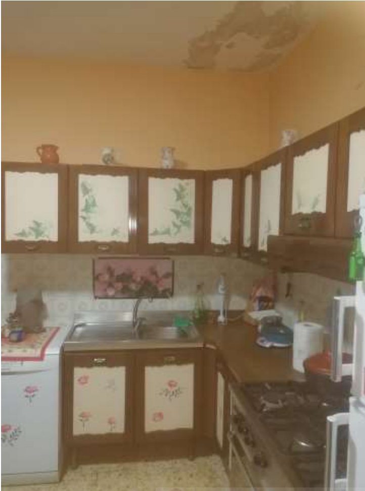
6. Foto interno cucina al piano primo (si evidenziano infiltrazioni sul solaio)
