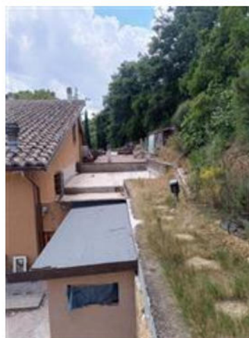
LOCALE REALIZZATO SENZA TITOLO EDILIZIO -- COPERTURA
