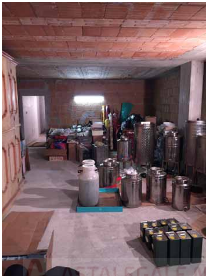
Foto 77 (zona abusiva da ripristinare)
