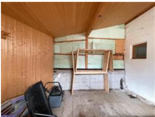
Spazio coperto ad ovest (non autorizzato)
