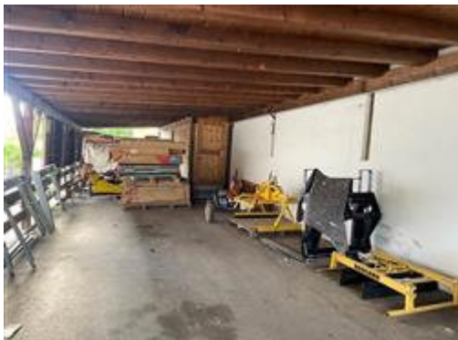
Tettoia esterna a sud (non autorizzata)
