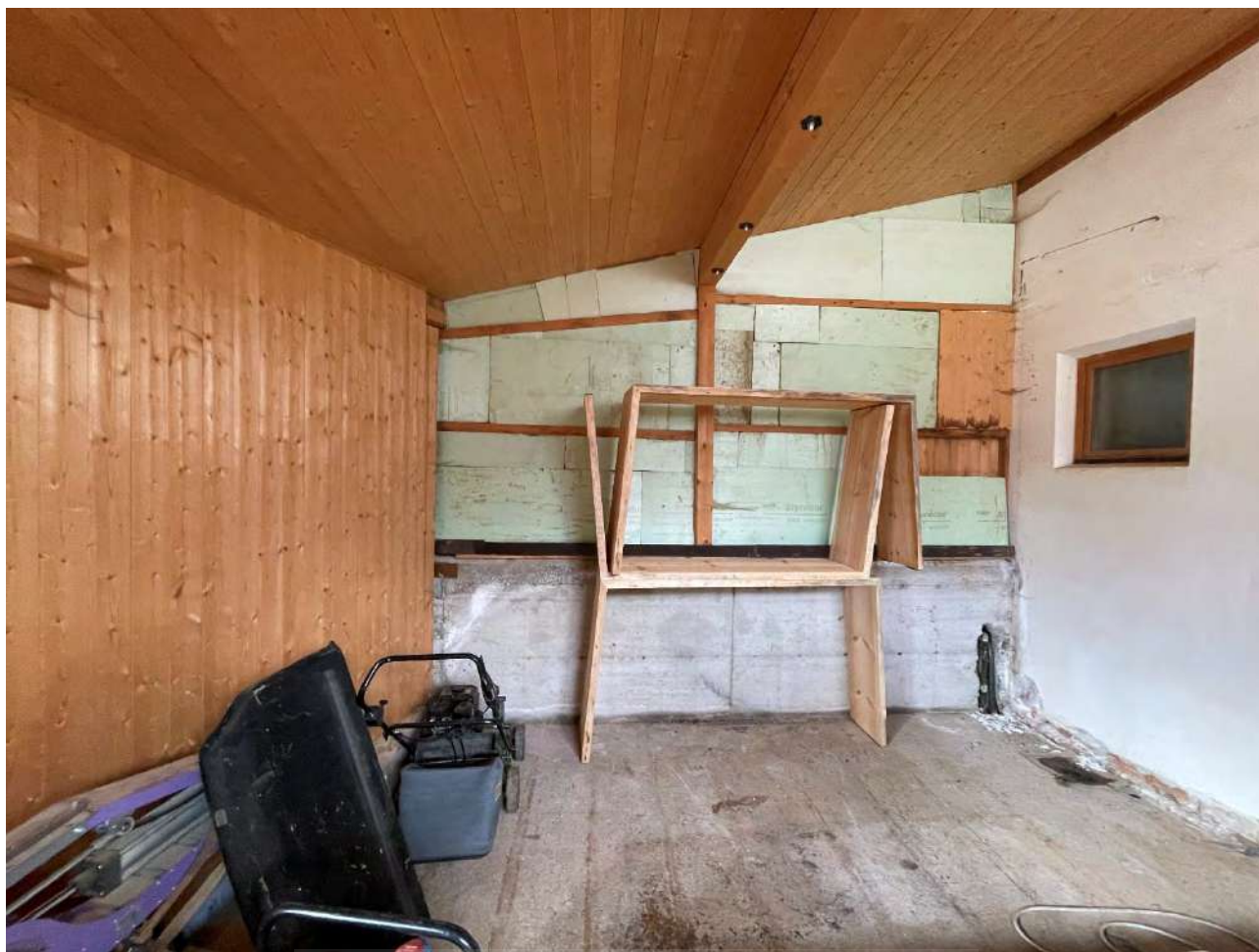
Vano esterno non autorizzato
