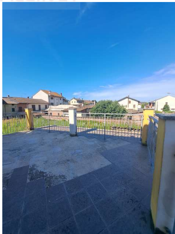
Figura 38- pavimentazione terrazzo - non integra
