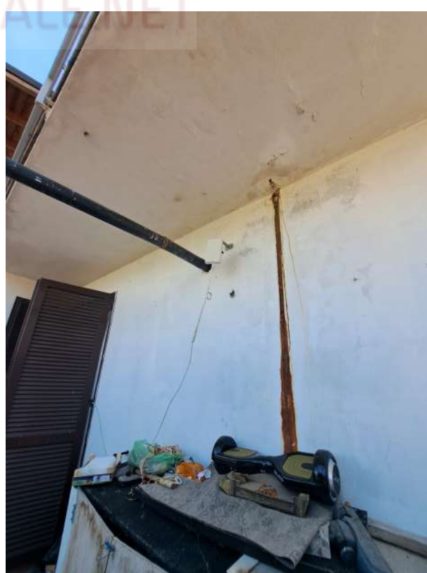
Figura 7- facciata ovest - infiltrazioni
