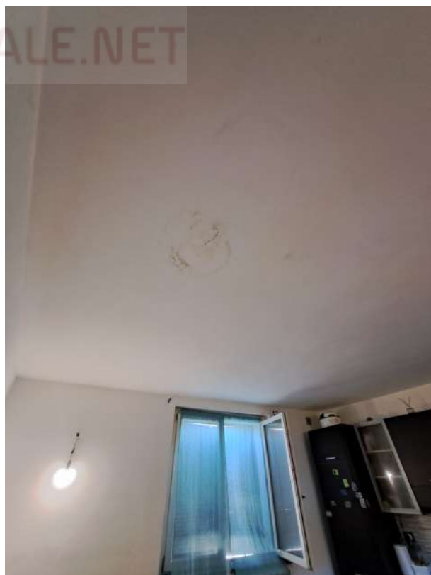
Figura 15- infiltrazione a soffitto
