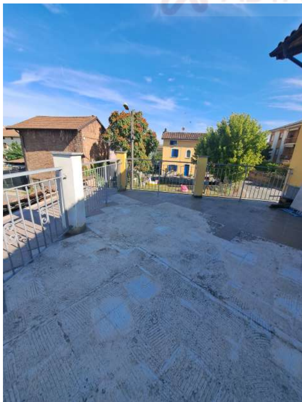
Figura 37- pavimentazione terrazzo - non integra
