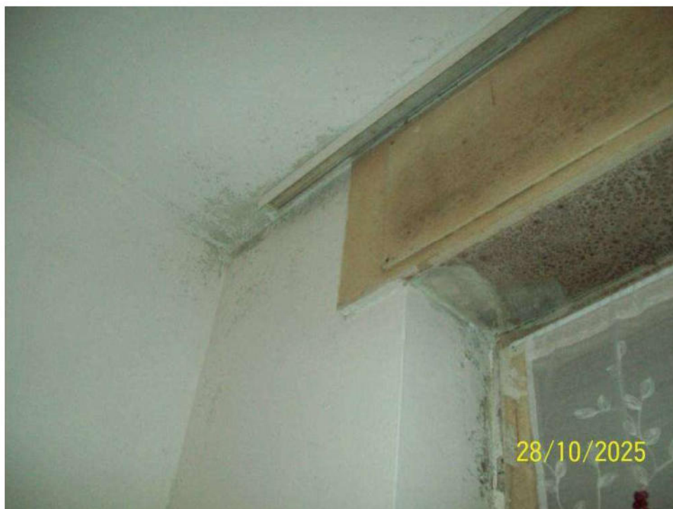
FOTO 8 – presenza di muffa camera abitazione “lotto 1 corpo A”
