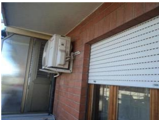
Condizionatore zona giorno appartamento Sub.4
