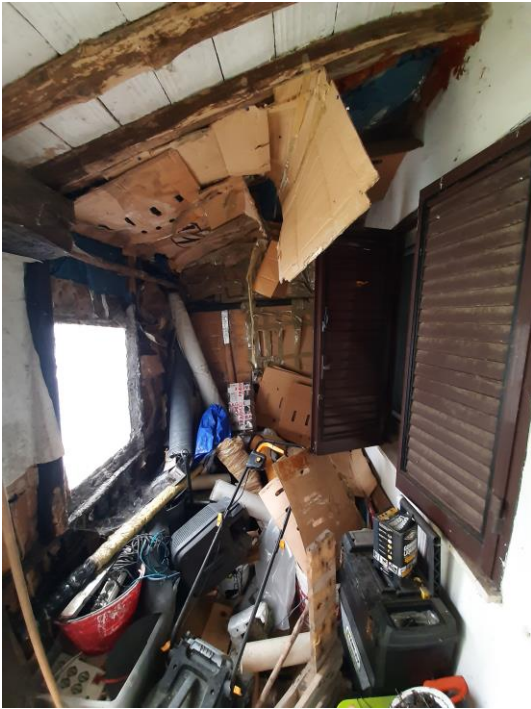
Manufatto abusivo da rimuovere
