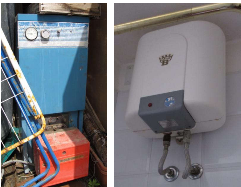
Fig. 13 e 14 – La caldaia e lo scaldacqua elettrico
