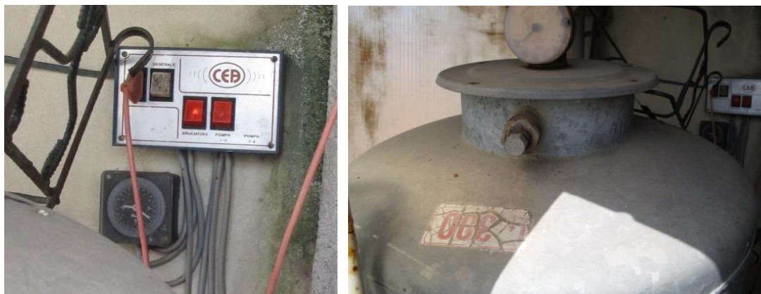
Fig. 11 e 12 – Interruttore bruciatore e pompa; serbatoio gasolio
