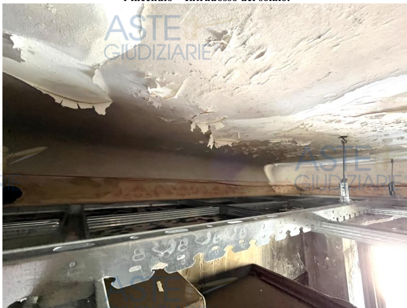
Fig. 4 – La camera da letto matrimoniale nella quale si è sviluppato l'incendio – Intradosso del solaio.
