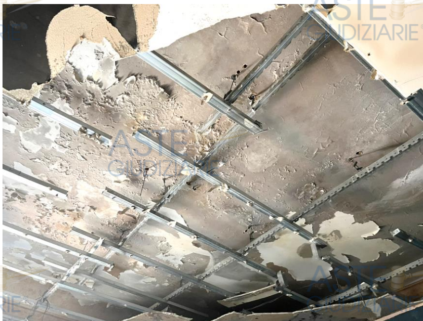
Fig. 2 – La camera da letto matrimoniale nella quale si è sviluppato l'incendio – Intradosso del solaio.
