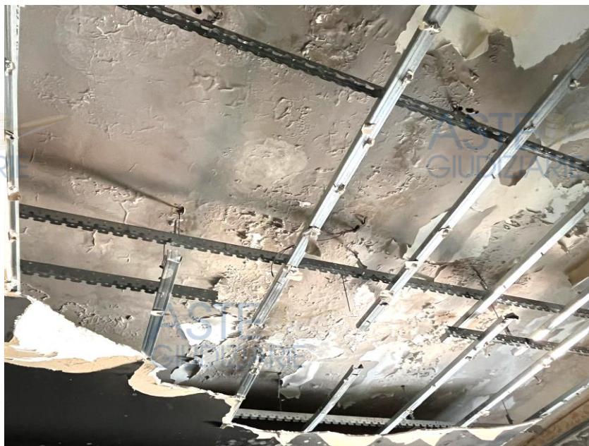
Fig. 1 – La camera da letto matrimoniale nella quale si è sviluppato l'incendio – Intradosso del solaio.
