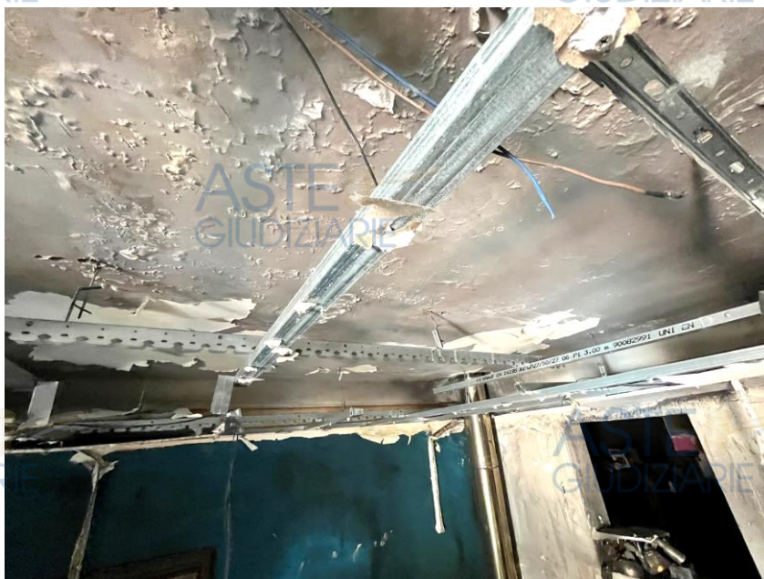
Fig. 3 – La camera da letto matrimoniale nella quale si è sviluppato l'incendio – Intradosso del solaio.
