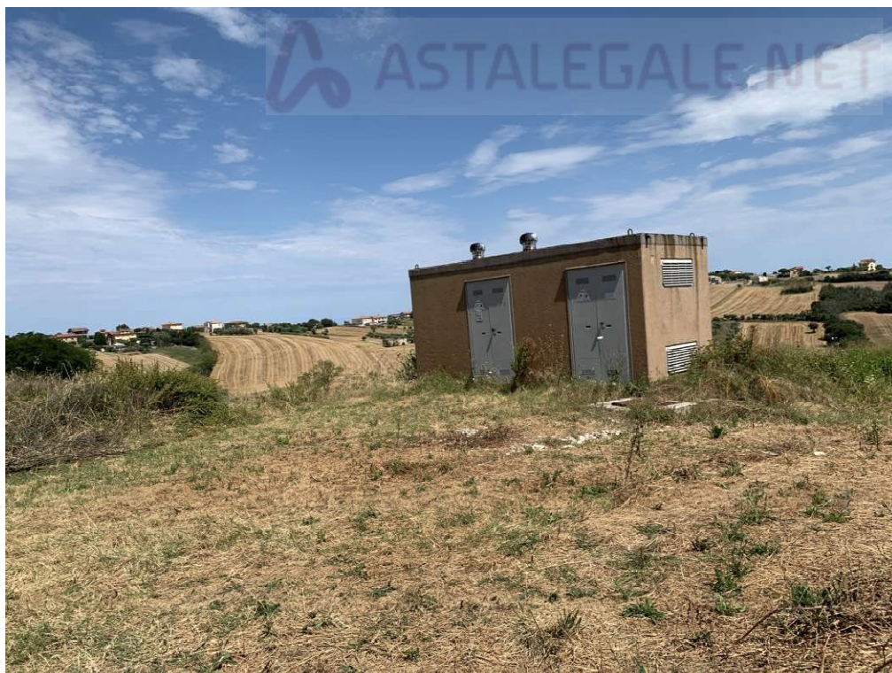
FOTO N.6_vista della cabina enel non oggetto di pignoramento.
