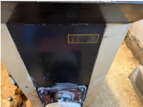
TARGA CALDAIA E BOILER ELETTRICO
