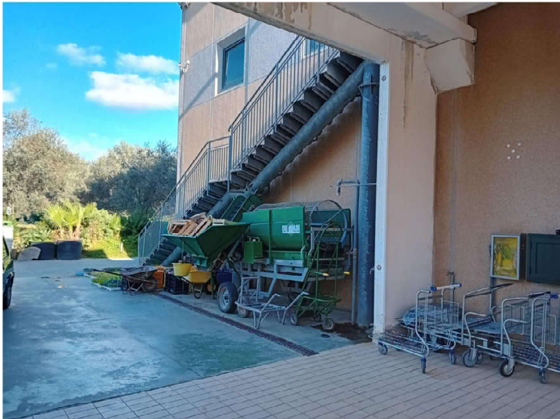
SCALA ANTINCENDIO AL PIANO PRIMO
