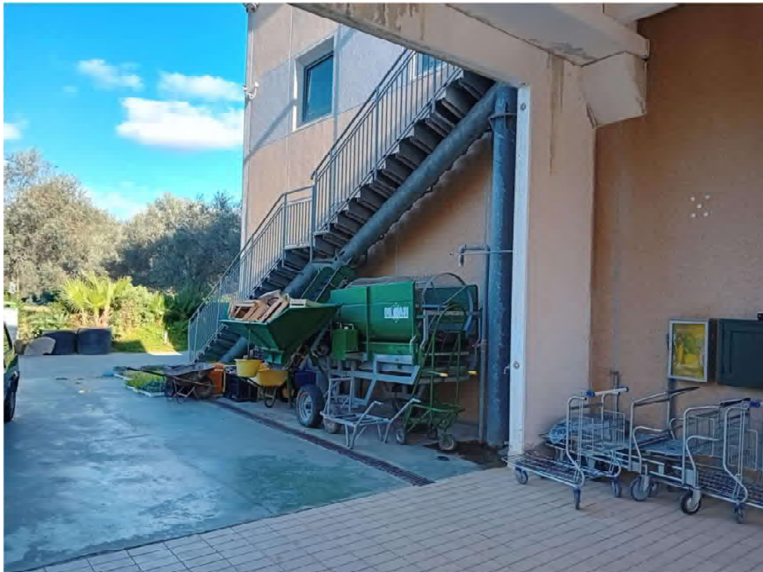
SCALA ANTINCENDIO AL PIANO PRIMO
