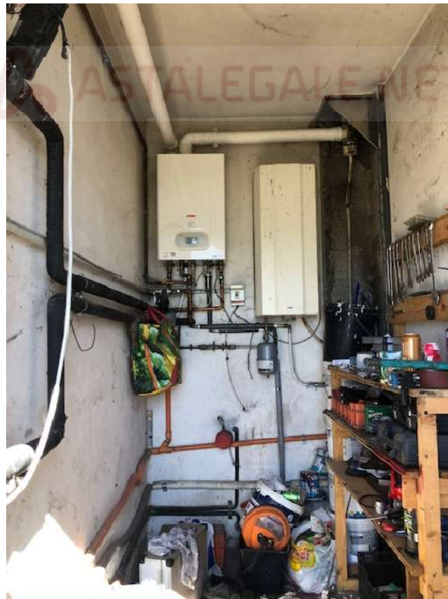
Foto 9 – centrale termica sub 4
