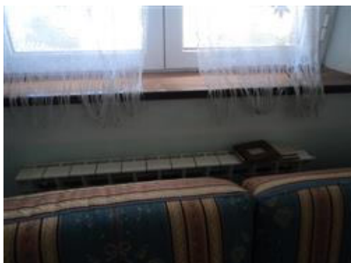
particolare finestra in pvc e radiatore in alluminio
