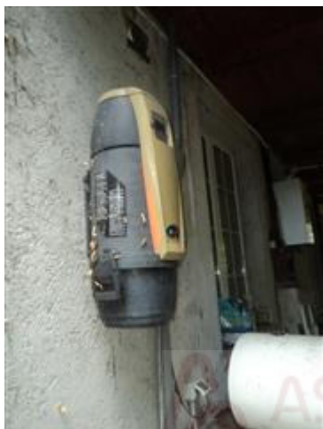
Impianto di aspirazione e caldaia PT.
