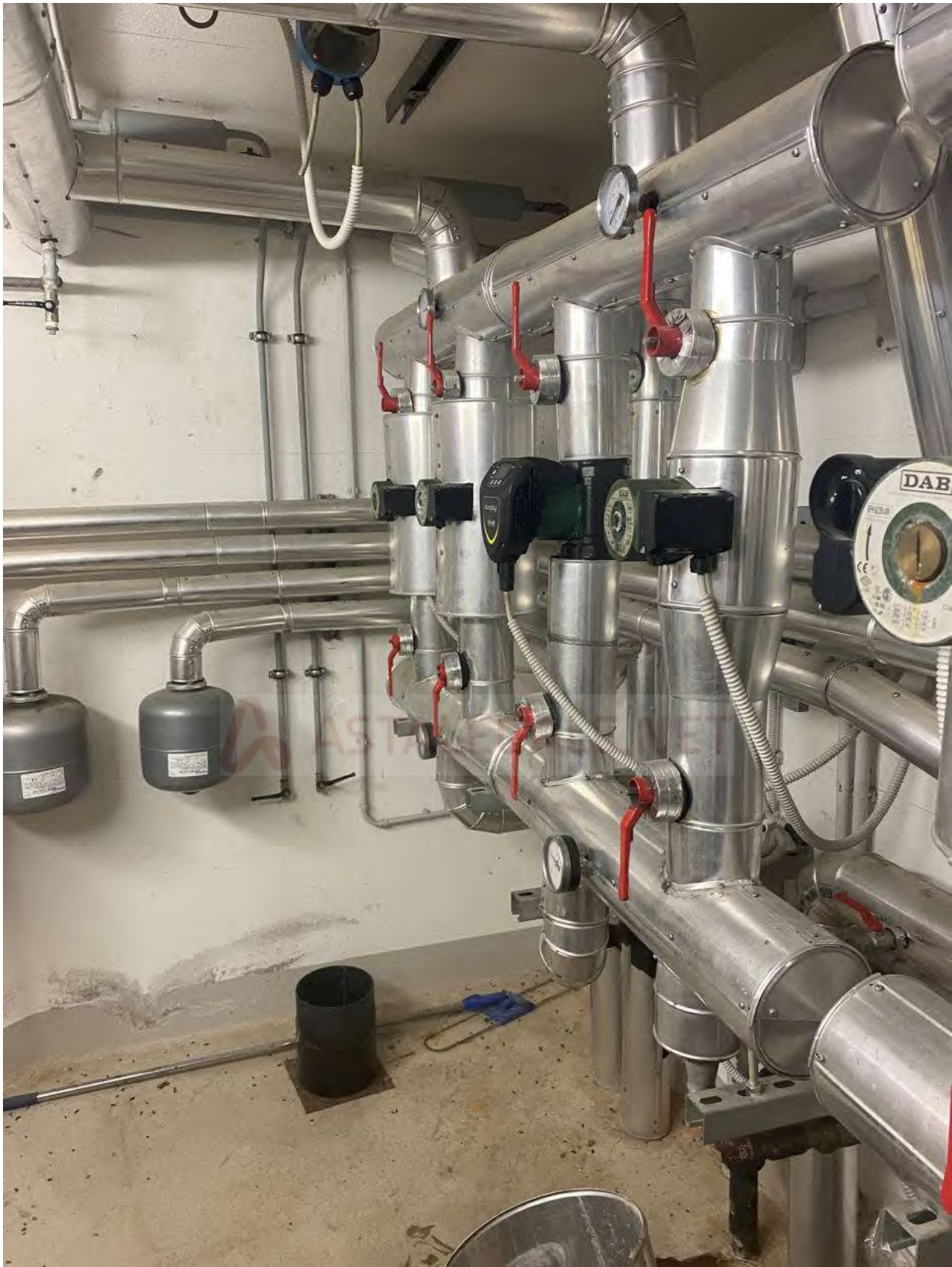
Fot. 22 - Vista dei dettagli impiantistici della centrale termica comune.
