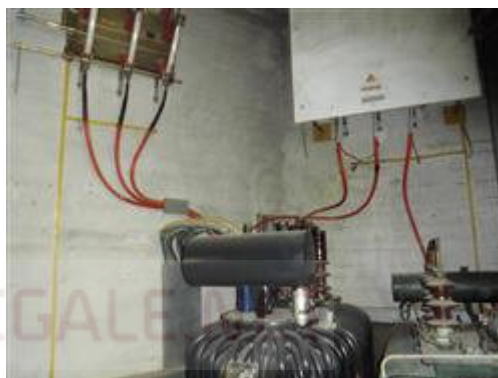
ingresso Linea da cabina ENEL
