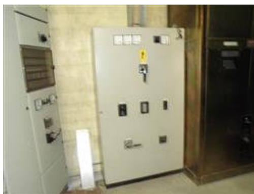
quadro elettrico generale
