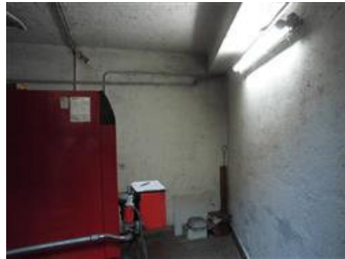
locale caldaia al piano interrato
