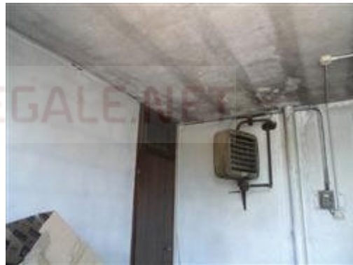
deposito a soffitto piano con aerotermo e zona con umidità
