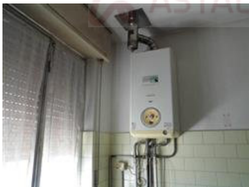
caldaia abitazione piano secondo
