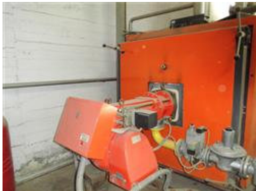
locale caldaia capannoni
