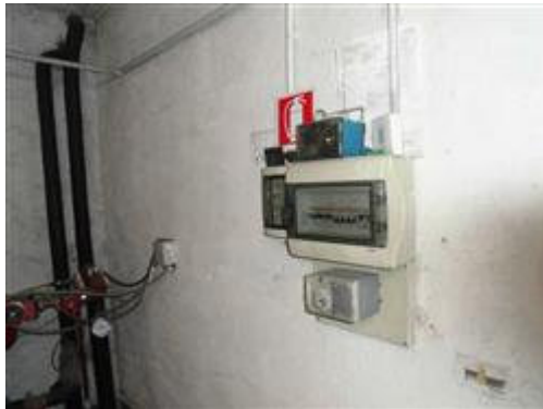
quadro elettrico caldaia
