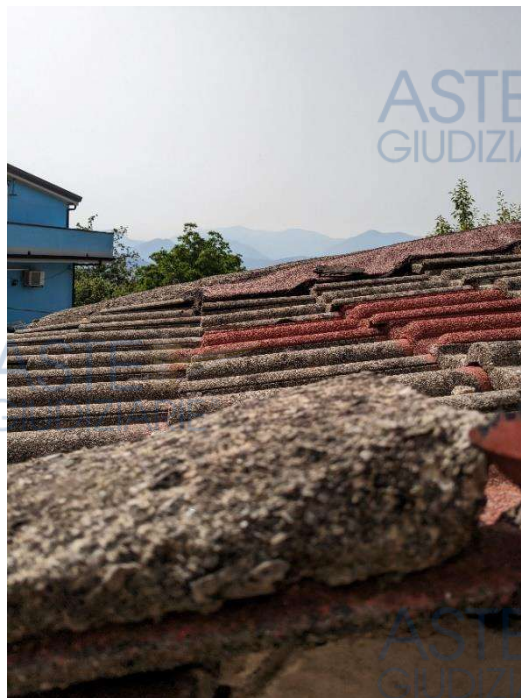
Foto 31: Il manto di copertura necessita di revisione di tenuta e messa in sicurezza.
