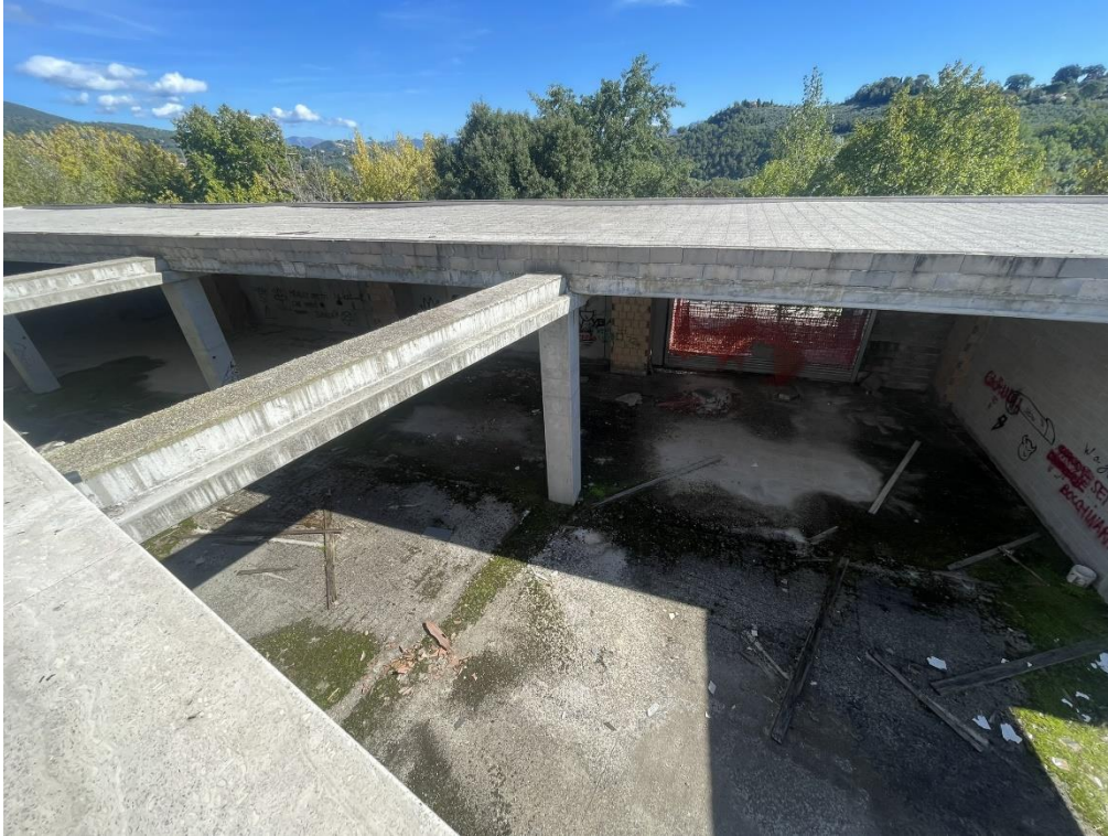
Fotografia n.20 – Piano Terra – Visuale degli spazi interni destinati a Supermercato ripresi dal Piano Primo.
