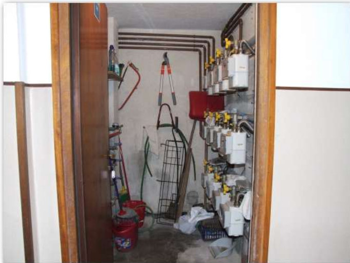
26. Locale contatori gas metano e acqua
