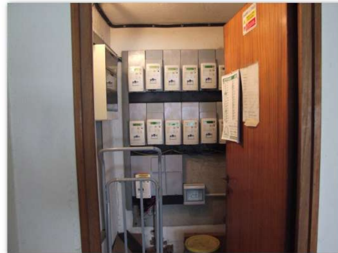
27. Locale contatori elettrici
