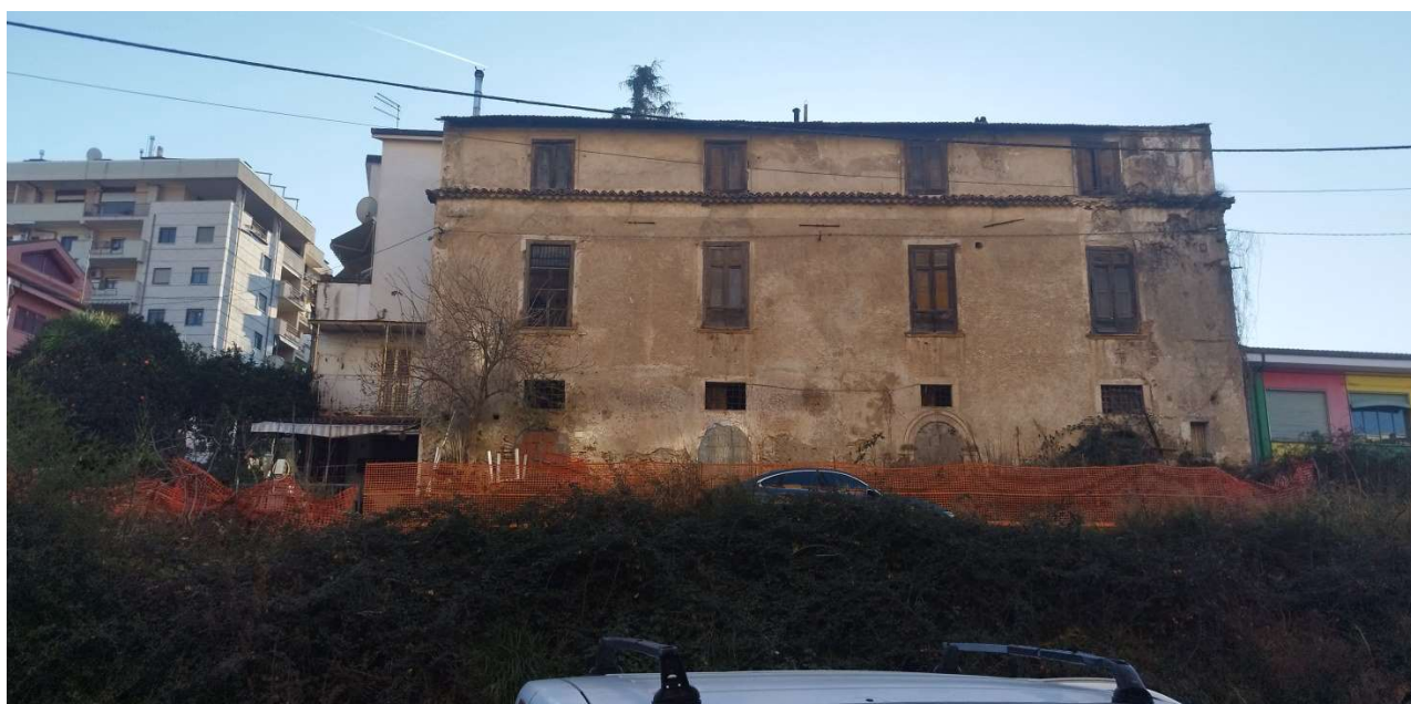
FOTO N°8: FABBRICATO DA DEMOLIRE, P.LLA N°1226, PROSPETTO EST;
