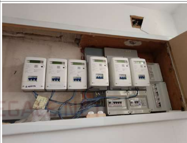
Quadri energia elettrica su scala condominiale
