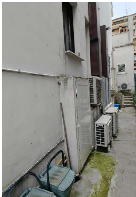
Corte esterna consominiale con quadri gas etc
